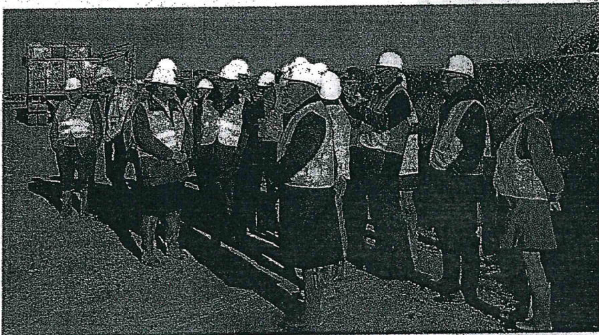
Les élus ont découvert le chantier actuel, le travail préparatoire à la bache de reprise, le réservoir intermédiaire.
